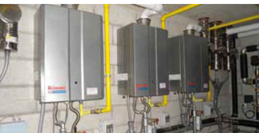
La batteria di produttori Acs istantanei Infinity da 54 kW a condensazione che, insieme con il preriscaldamento solare, forniscono l'acqua calda sanitaria alle 14 docce della palestra
