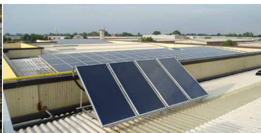
Gli impianti solari, termico e fotovoltaico, a servizio della struttura
