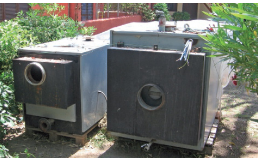
PRIMA DEI LAVORI. I generatori del vecchio impianto.
