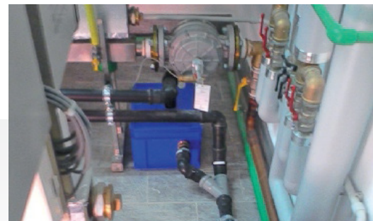
SICUREZZA. Dettaglio VIC, valvole di intercettazione combustibile
